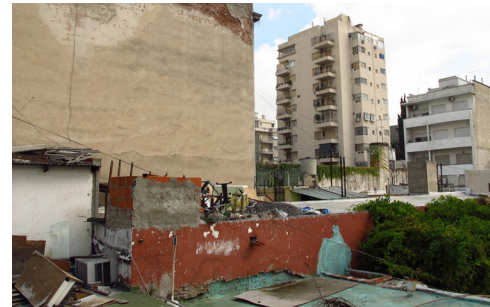
Los techos del fondo de la casa con extensiones ilegales llenas de basura y escombros.
